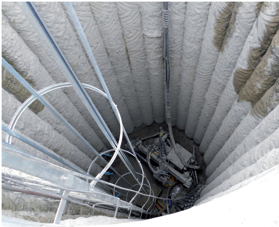
Attività all'interno di pozzi
